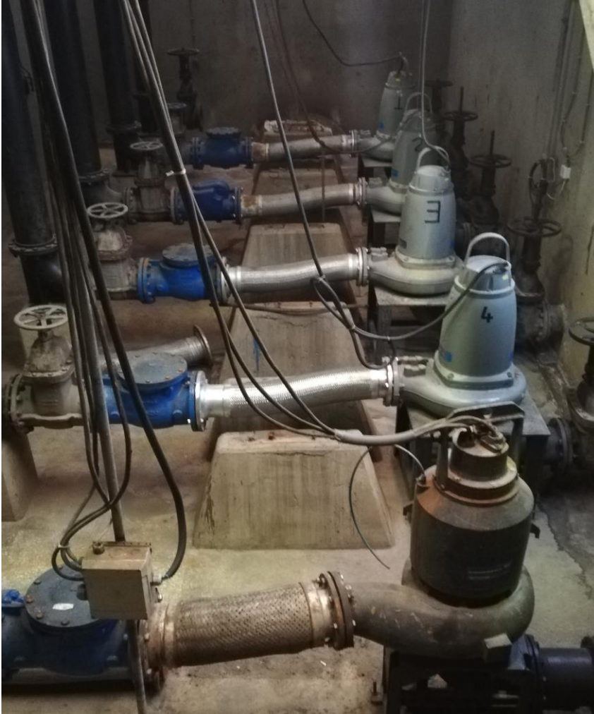
1.Kısım Giriş Pompa İstasyonu
