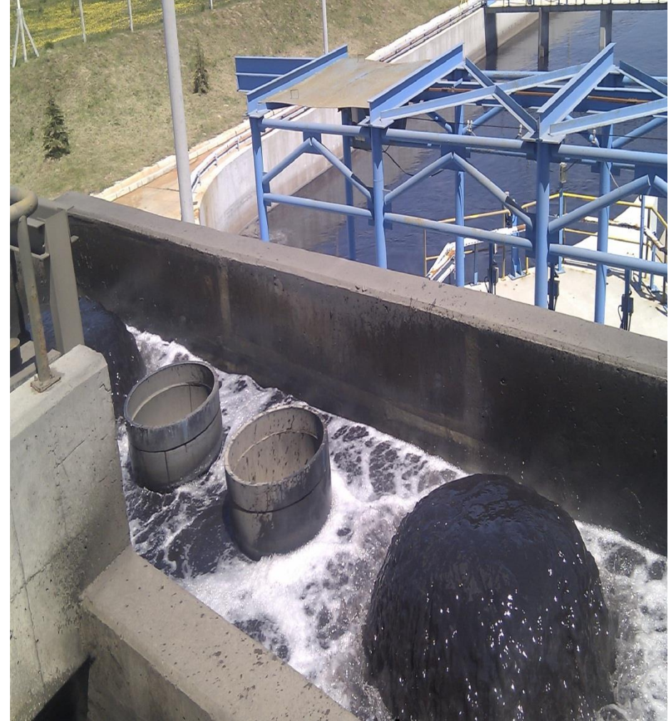
2.Kısım Giriş Pompa İstasyonu
