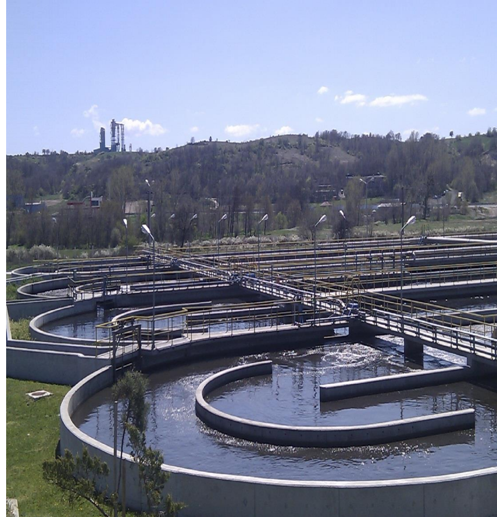
2.Kısım Biofosfor Havuzu
