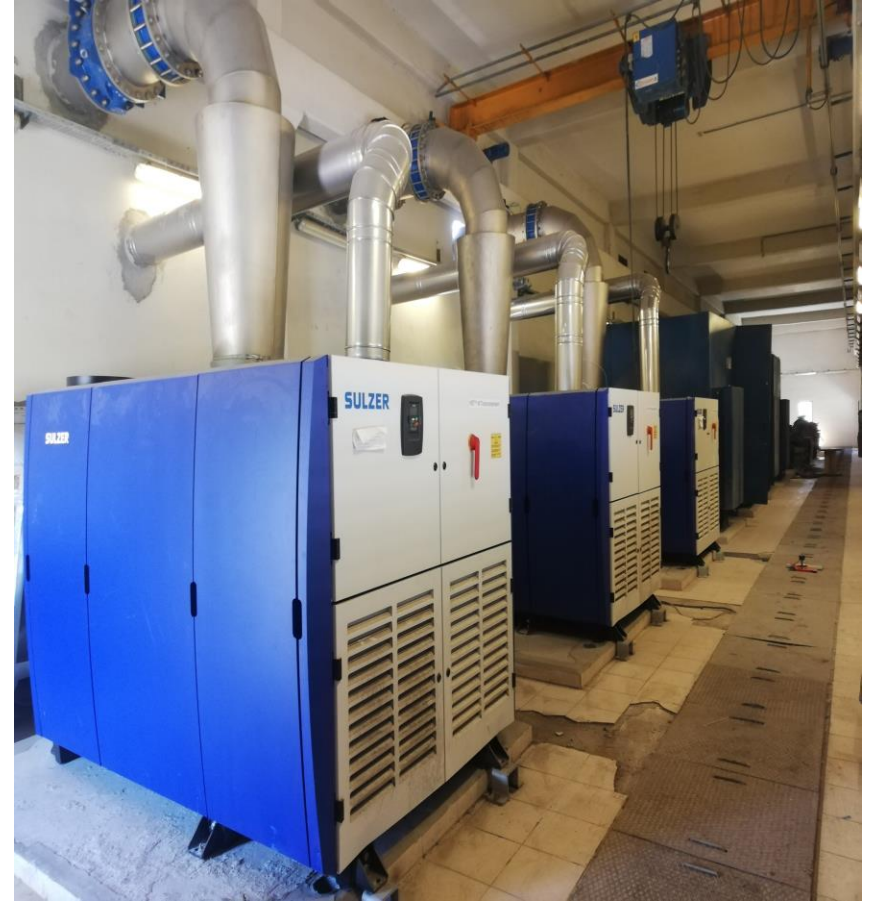
2.Kısım Havalandırma Havuzu Blowerları
