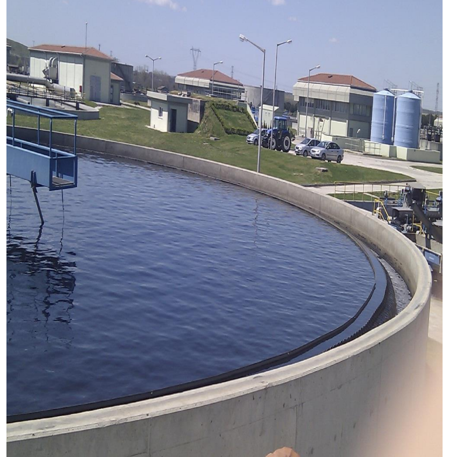
2. Kısım Ön Çöktürme Havuzu
